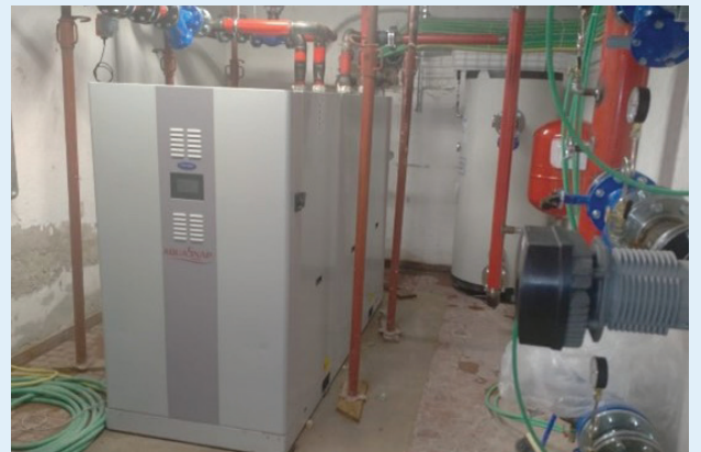
Efter: pannrum efter åtgärden med den nya värmepumpen
