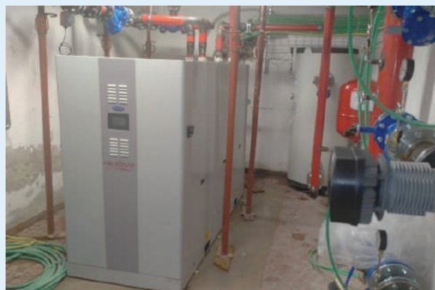
Depois: sala das caldeiras após a intervenção com a nova bomba de calor
