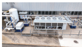
30KAV agregaty wody lodowej chłodzone powietrzem
