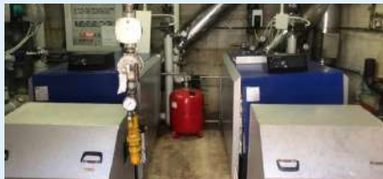
Prima: locale tecnico caldaie
