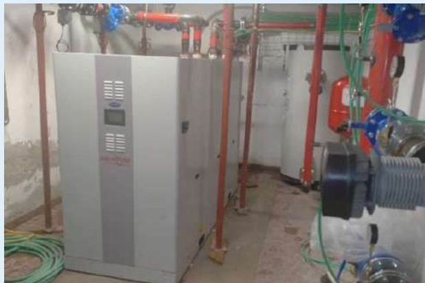
Dopo: locale tecnico post-intervento con nuova pompa di calore
