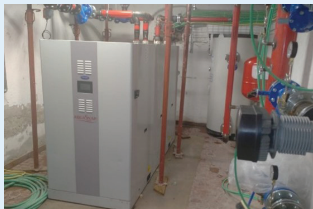
Après : chaufferie après l'intervention avec la nouvelle pompe à chaleur
