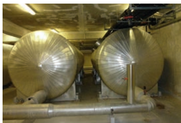
L'installation de production de froid avec 4 cuves de stockage
