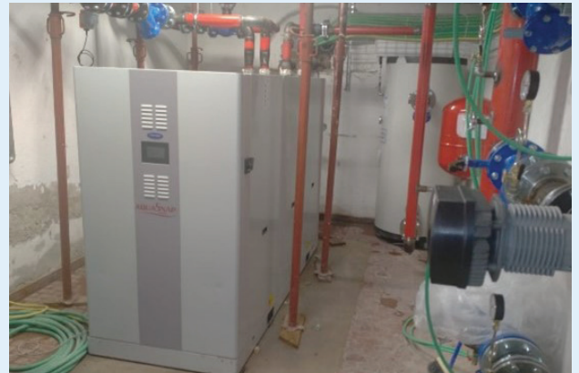
Jälkeen: boilerihuone ja uusi lämpöpumppu tehdyn toimenpiteen jälkeen
