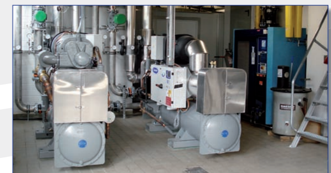
Eine der Kältezentralen
